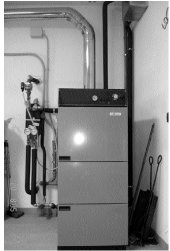
Una caldaia a legna integrata con l'impianto solare
