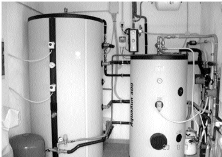
Un esempio di un impianto solare per la produzione di acqua calda.
